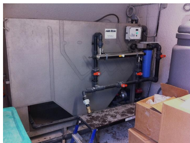
Unité de décantation-filtration-désinfection
