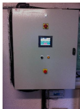
Armoire de commande générale
