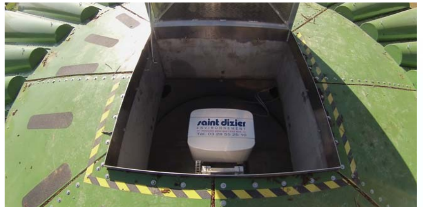
Tête d'aspiration dans son regard sous la couverture
