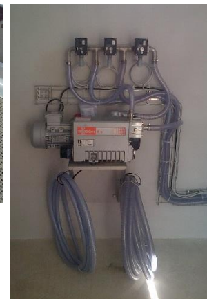
Equipements dans le local technique
